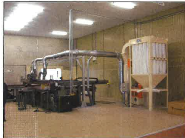
樹脂切断屑集塵:KBF-5.5(5.5kw) 「フィルター特殊仕様」
