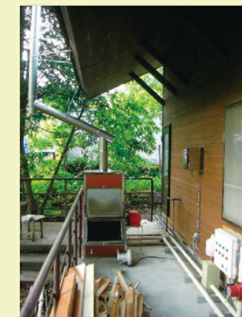
エーテオーウッドボイラー導入 (長野県軽井沢町)
